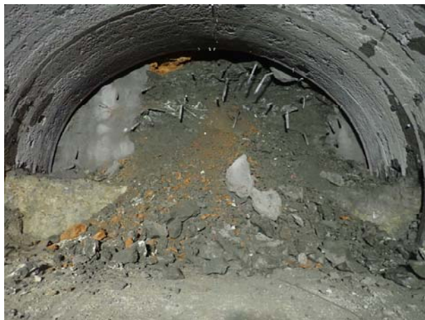
図-2 切羽崩落状況（TD=750m付近）
