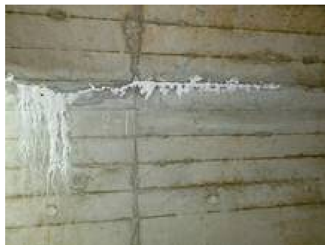
図5 クラック及び遊離石灰の溶出(監査廊内)
