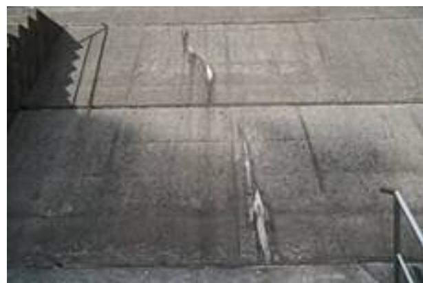
図4 クラック及び遊離石灰の溶出
