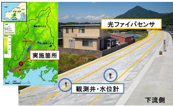
図4 観測位置と観測機器の設置状況
