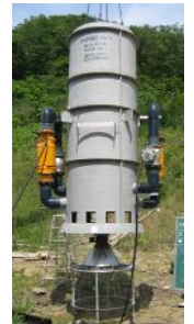
重金属類対策施設
