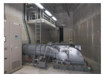
管理用発電施設内 水車・発電機
