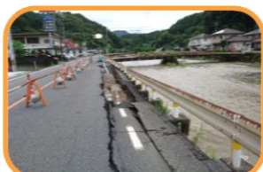
被災状況(H30年7月7日)
