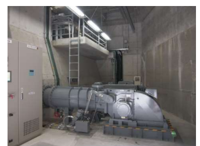
管理用発電施設内 水車・発電機
