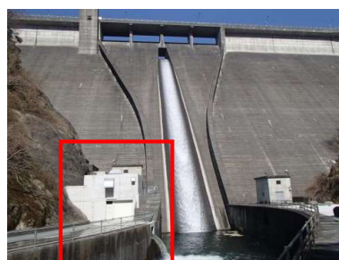
管理用発電施設（H24年度設置）
