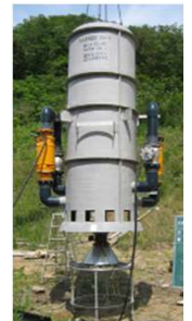
重金属類対策施設
