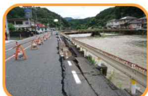
被災状況(H30年7月7日)
