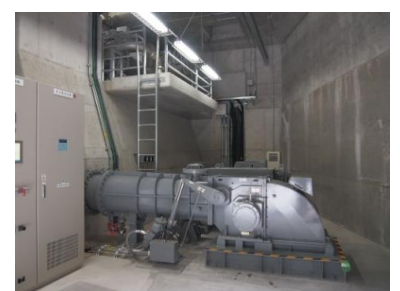
管理用発電施設内 水車・発電機 12
