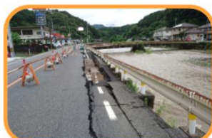
被災状況(H30年7月7日)
