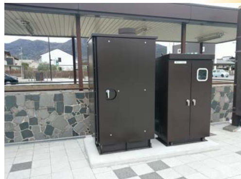
▲地下道非常用電源設備 停電時に稼働し、照明やカメラ、 排水ポンプの電源を維持する設備
