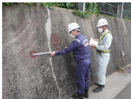
擁壁変状状況（萩市大井）
