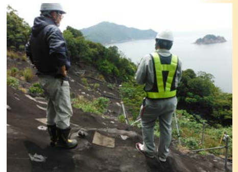
法面変状状況（阿武町木与）
