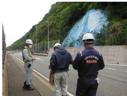
応急処置状況（萩市大井）
