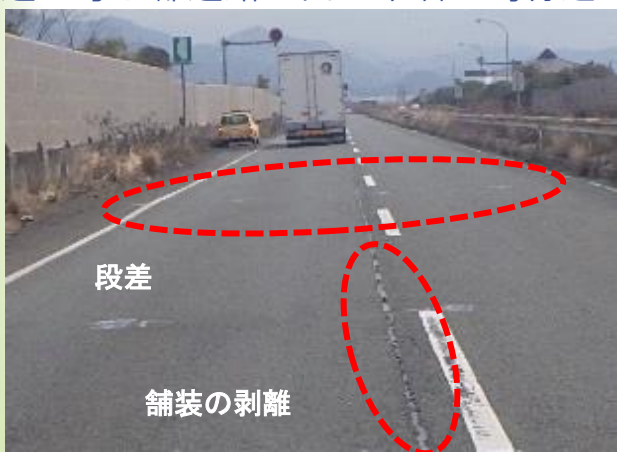
着手前（舗装の段差や剥離などがありました）
