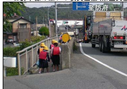
▲歩道が低く圧迫感がある船木大橋の歩道
