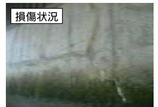
縦壁のひび割れ
