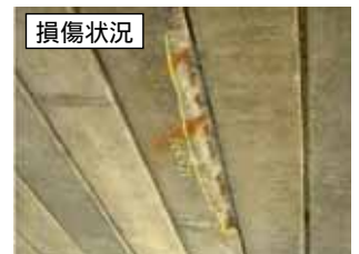
主桁の剥離・鉄筋露出
