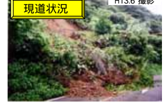
現道(国道491号)の災害状況
