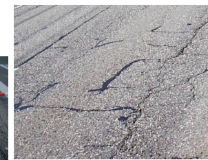
舗装のひび割れ
