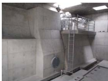
設備内の状況
