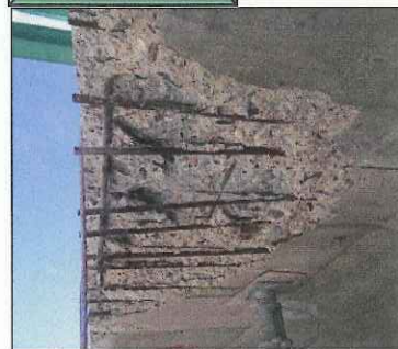
鉄筋の露出状況
