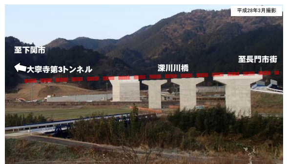
写真② 事業進捗状況 (長門市街方面から下関方面を望む)
