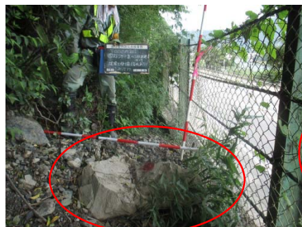
既存防護柵背面の土砂堆積状況
