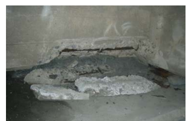
【損傷状況】コンクリート落下
