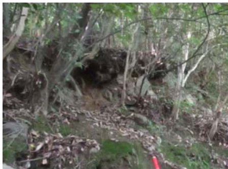
崩落斜面状況
