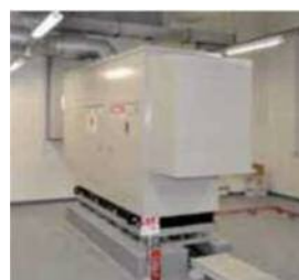
非常用発電設備のイメージ
