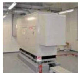
非常用発電設備のイメージ
