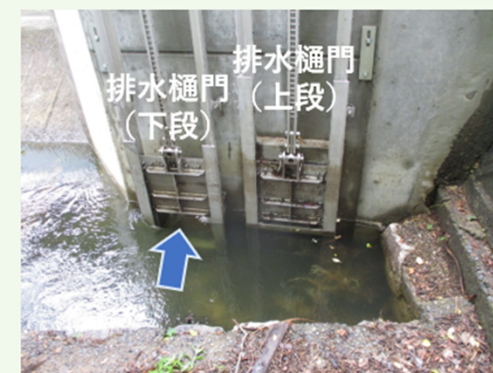
排水樋門(下段)からの排水状況
