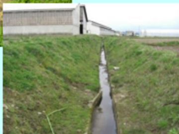
水路側壁の倒壊
