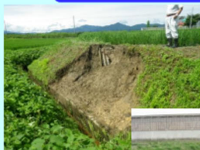
水路法面の崩壊
