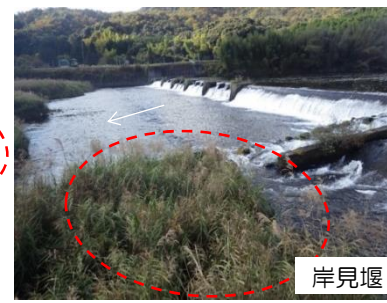
魚道直下流に土砂が堆積している
