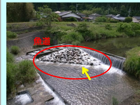
【整備後の魚道の例】
