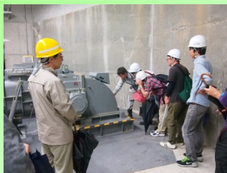
管理用発電機室
