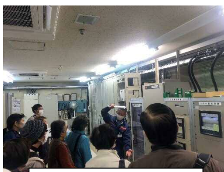
ダム内の計測機器
