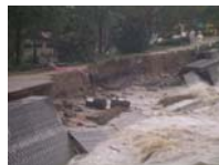
高潮による護岸の被災状況(旧太田川)
